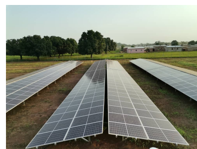
Mali: Ländliche Elektrifizierung
